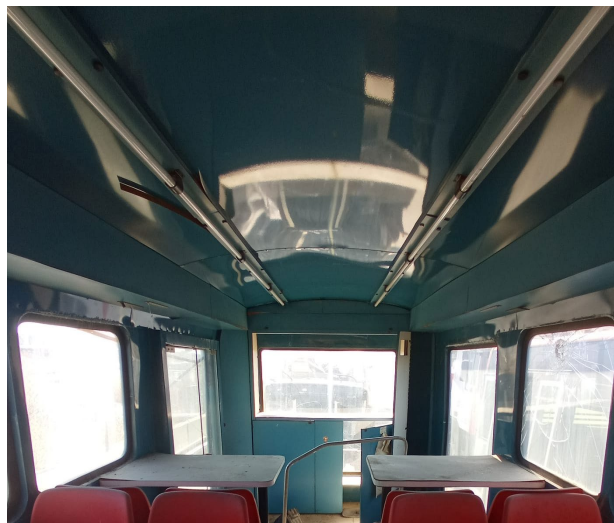
Imatge 36: Estat actual dels agafadors laterals
