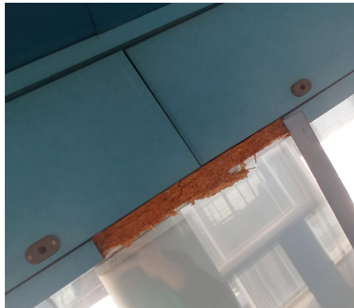
Imatge 39: Estat actual dels prestatges laterals
