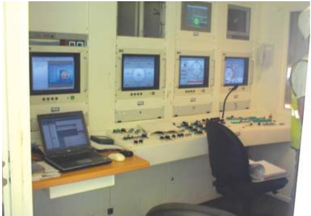
Centre de control de la tuneladora.
