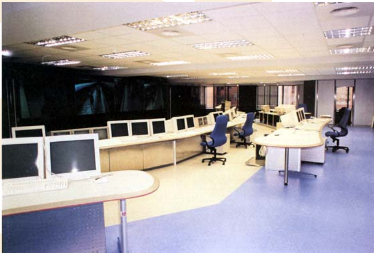
Vista parcial CCM en fase de muntatge.
