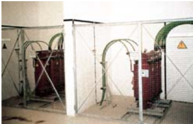
Centre de transformació quadres elèctrics de les estacions de la línia de l'EXPO.
