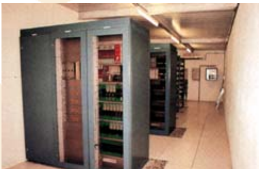
Nuevo enclavamiento electrónico en L5.
