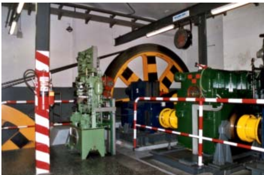
Vista general de la sala de máquinas en la que se puede apreciar los motores, una polea amarilla y parte de la segunda polea.
